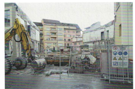
Das gewaltige Loch, das während des Neubaus des Mittelteils klappte. (Foto: Kantonale Denkmalpflege)
